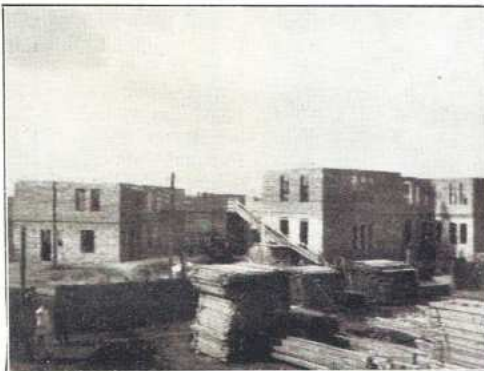
Épülő kórházi pavillon. — Im Bau befindliche Krankenhausgebäude. — Pavillons d'hôpital en construction. — Hospital-pavillons in construction.
